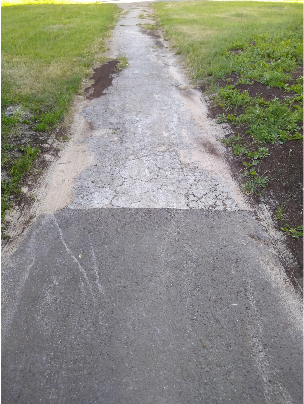
Joonis 2. Akadeemia tee 42 ja Akadeemia tee 32b vahelise kõnnitee seisukord (lõhenenud ebatasane asfalt, umbrohu mügarikud, afaltiaukude täitmine mullaga)
